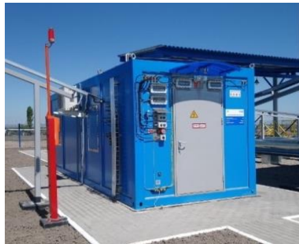
В блок-контейнере приборном
